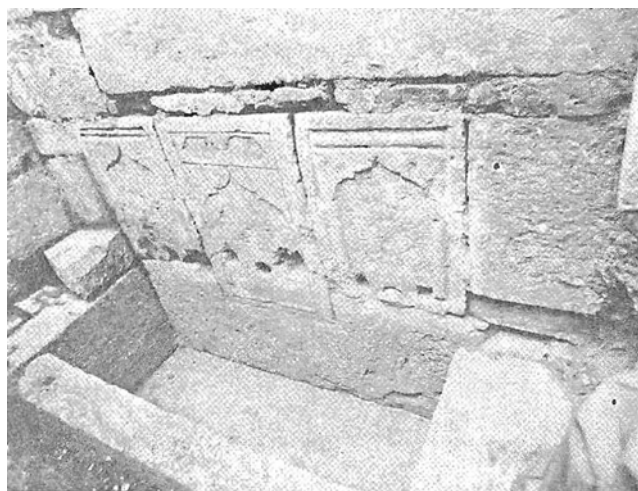
Сл. 12. Северозападна фасада Чесме Мехмед-паше Соколовића – детаљ каменог корита са декоративним плочама и отворима за луле
